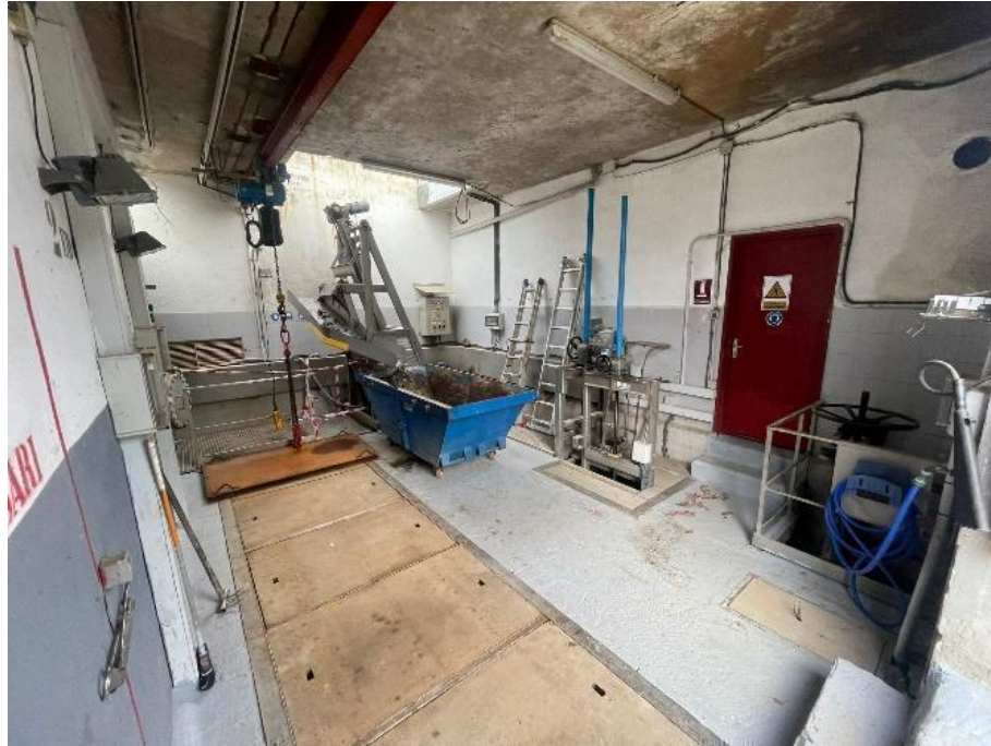
Imatge 1.- Sala principal del EB4 Principal d'Arenys on hi ha el pou de bombes (bombes a planta i bombes a emissari) i la reixa de desbast, entre altres equips.
