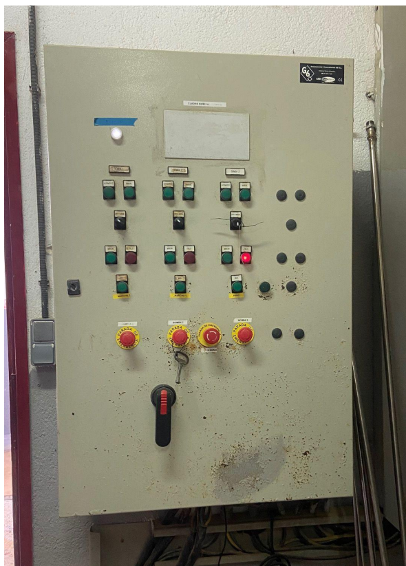
Imatge 4.- Quadre elèctric de bombes a emissari que es substituirà pel quadre elèctric nou.
