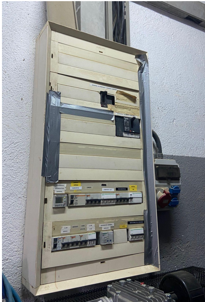
Imatge 3.- Quadre elèctric actual de l'interruptor general de les bombes a emissari i de l'enllumenat del bombament que s'eliminarà per unificar-lo amb el quadre elèctric que s'instal·larà nou.
