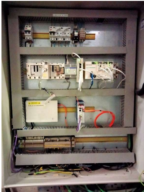
Imatge 9 Interior quadre PLC 70
