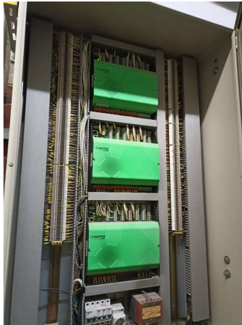
Imatge 2 Interior quadre P2.2 B1 costat P1
