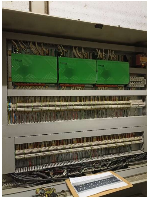
Imatge 4 Interior quadre P2.2 B3 costat P1
