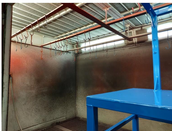
Figura 3 Interior de la cabina de pintura lagos
