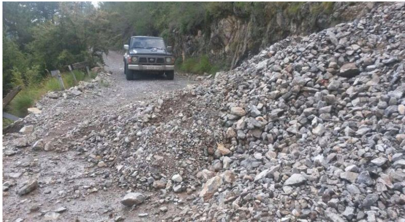
Figura 1. Despreniments d'elements gruixuts sobre el ferm
