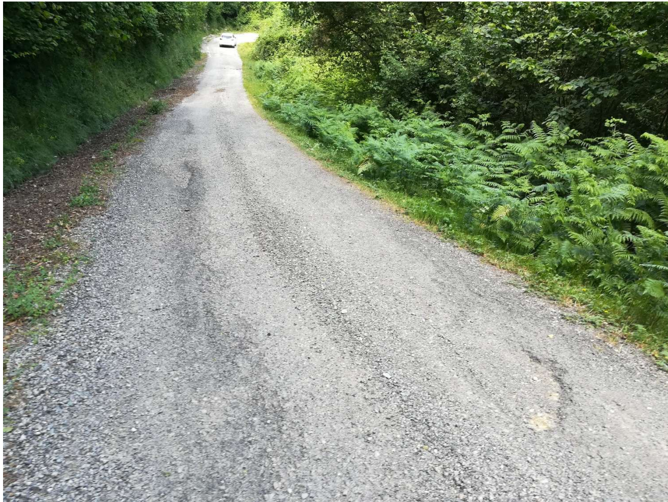
Fotografia 7. Tram de camí amb forta pendent i capa de rodadura força deteriorada, amb presència de diversos forats i graveta solta. PK 13+300 a 13+570. Correspon a l'actuació nº27.
