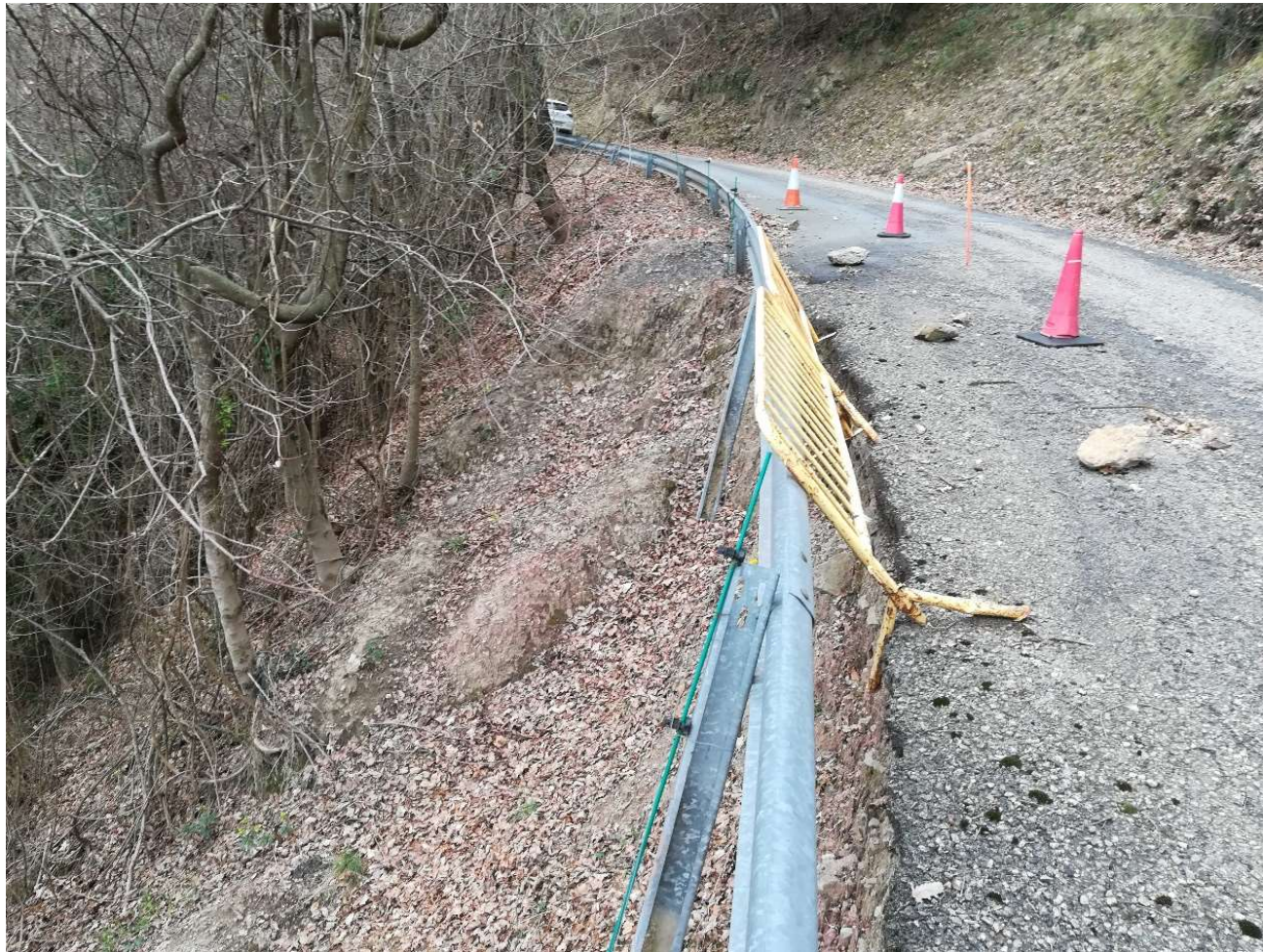
Fotografia 4. Detall de l'entorn del tram afectat pel despreniment.
