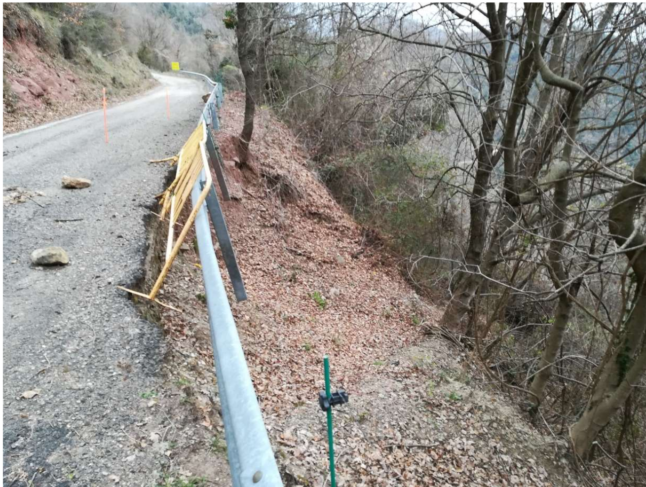
Fotografia 2. S'aprecien els suports de biona despenjats i el talús afectat per l'esllavissada.
