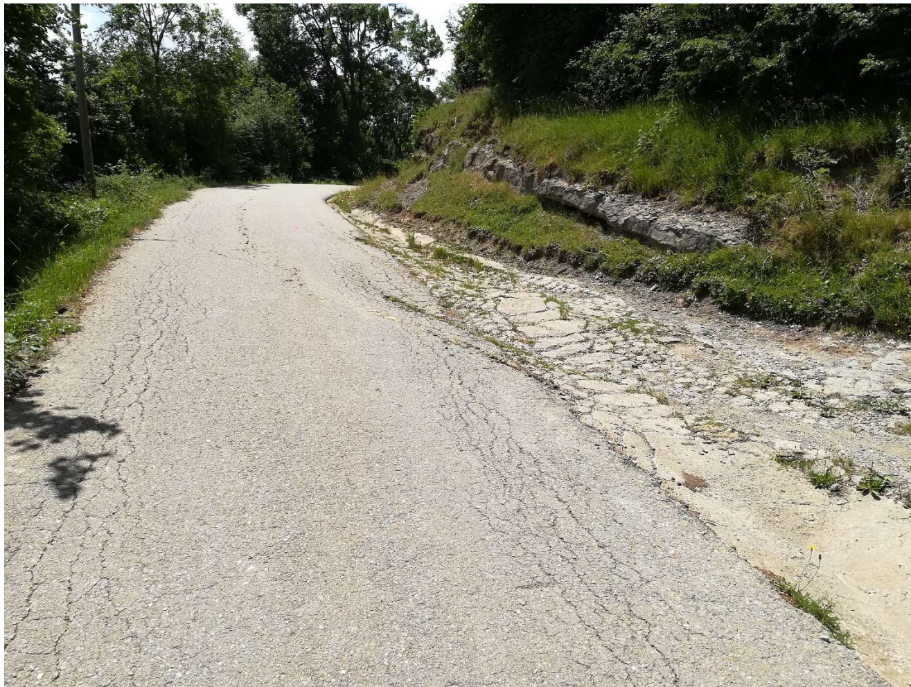
Fotografia 5. Estat del paviment a la bifurcació del camí de Sta. Magdalena de Cambrils, prop del Coll de Collfred. S'hi ha previst realitzar l'actuació nº1, tant a la pròpia calçada com també a la cuneta.
