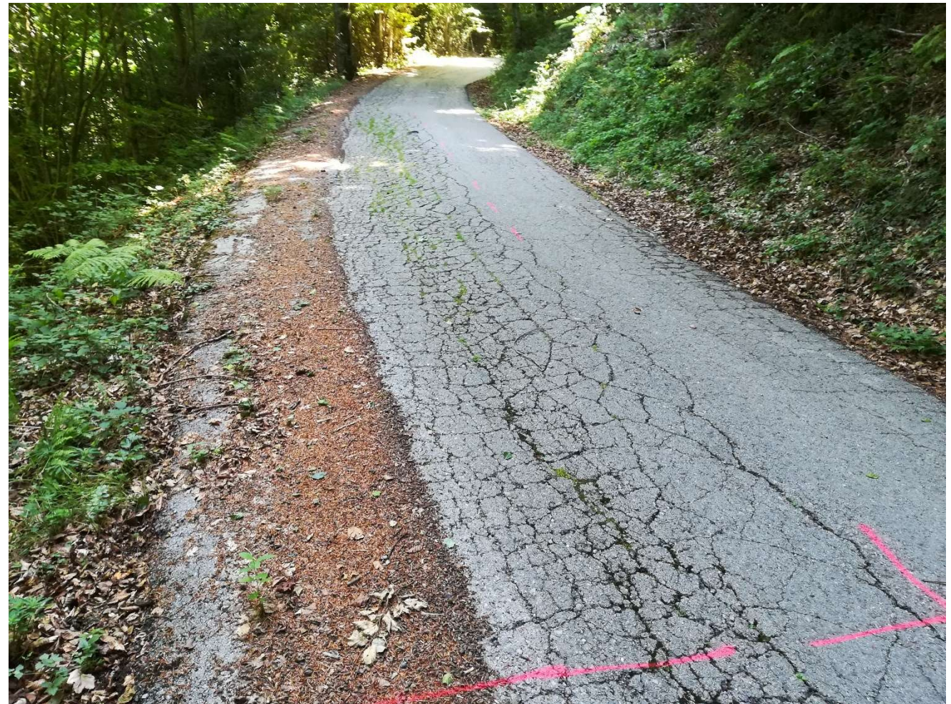
Fotografia 6. Calçada afectada per assentaments importants en una zona del camí molt obaga. Es preveu realitzar les actuacions nº19 a 24.
