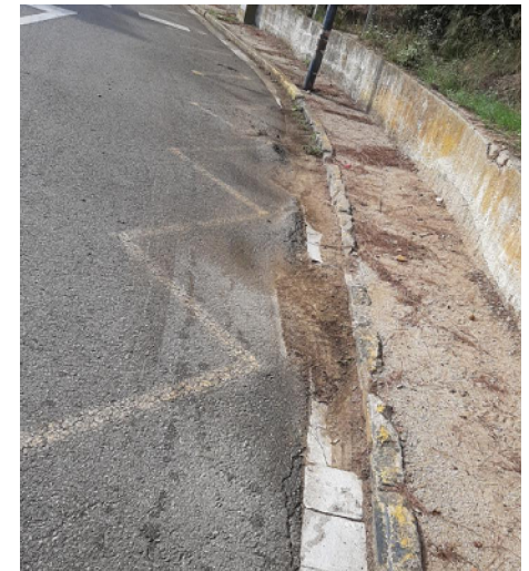
Zona asfalt a reparar
