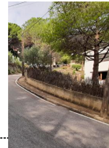
V2: Tram de vorera inacabat - Manca panot - Amplada 1,00m
