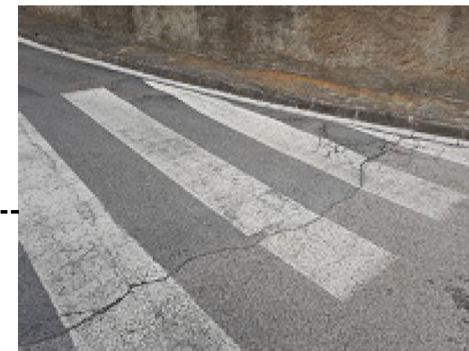
Zona asfalt a reparar
