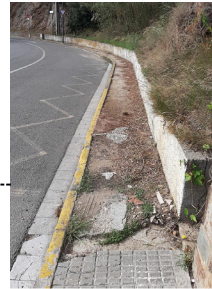
V3: Tram de vorera inacabat -Neteja i rebaix de vorera -Manca solera de formigó i panot -Amplada 1,00m
