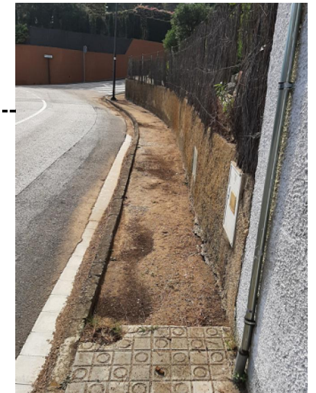
V2: Tram de vorera inacabat -Manca panot - Amplada 1,00m
