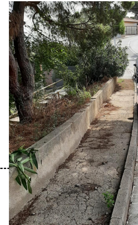
V1: Tram de vorera inacabat - Manca panot - Amplada 1,00m
