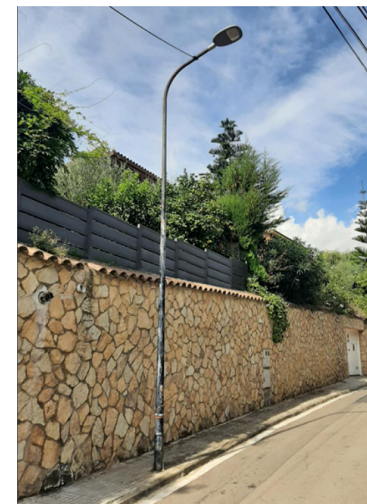
Substitució de bàcul existent per columna troncocònica de 8,00m d'alçada i trasllat de lluminària existent. (tram fanals 2 al 6)
