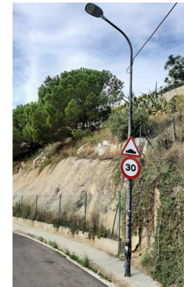
Substitució de bàcul existent per columna troncocònica de 8,00m d'alçada i trasllat de lluminària existent. (tram fanals 7 al 12)
