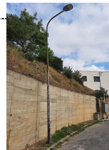
V4: Tram de vorera inacabat -Neteja i rebaix de vorera -Manca solera de formigó i panot -Amplada 1,00m
