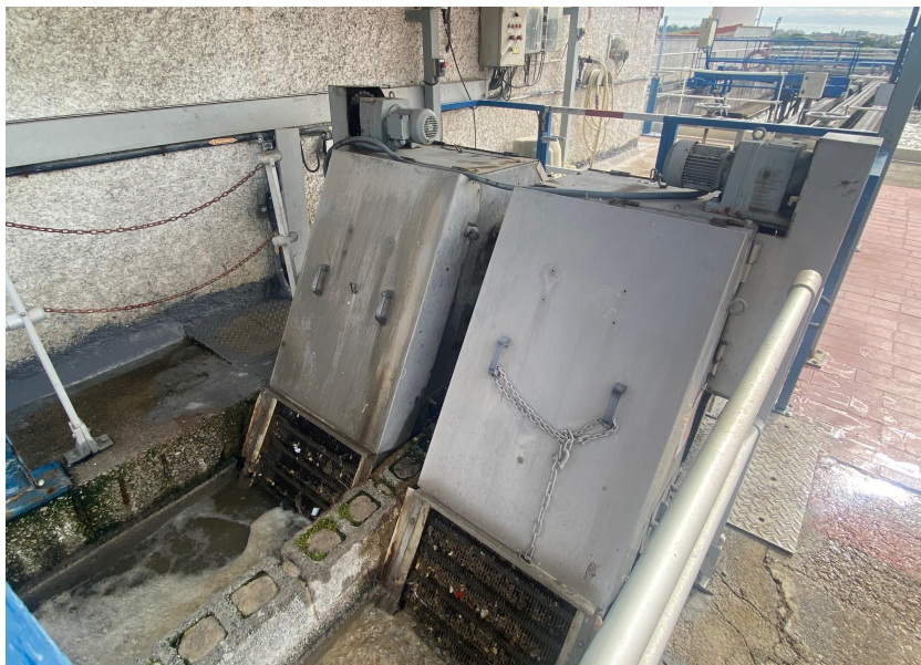
Imatge 1.- Tamisos actuals entrada EDAR Teià, de la marca Qilton, iguals que el que s'ha de subministrar i instal·lar.
