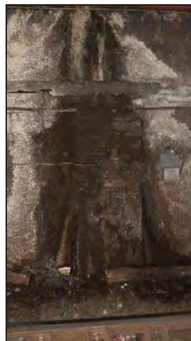
Foto 2: Filtració pantalla PK 105+310 v2.
