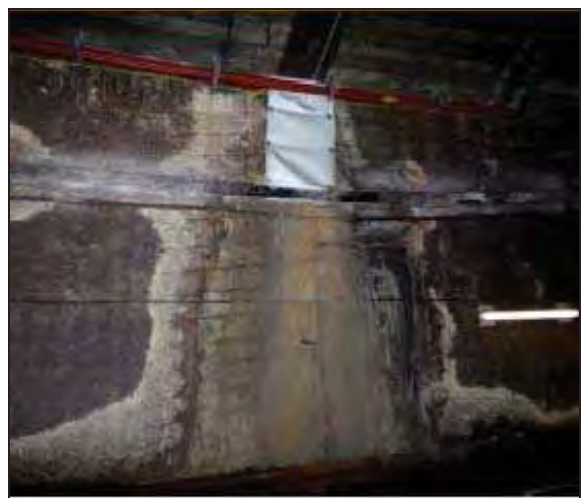
Foto 12: Armadura vista PK 105+550.
