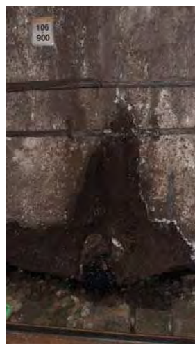
Foto 28: Filtració pantalla PK 106+900 v2.
