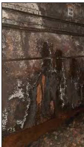
Foto 17: Filtració esquerra PK 106+400-8 v1.
