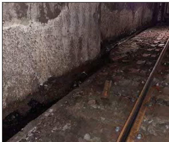
Foto 30: Filtració contravolta PK 106+900-950 v2.
