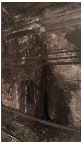
Foto 25: Filtració pantalla PK 106+890 v1.
