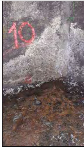
Foto 7: Filtració contravolta PK 105+840 v1.
