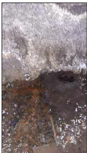
Foto 3: Filtració contravolta PK 105+660 v1.
