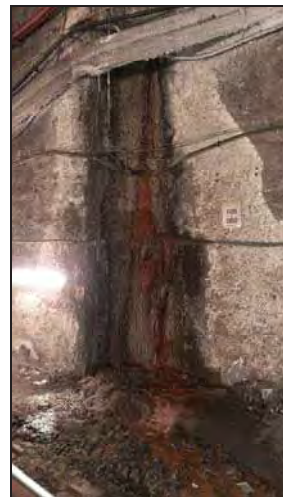
Foto 10: Filtració pantalla PK 106+080 v1.
