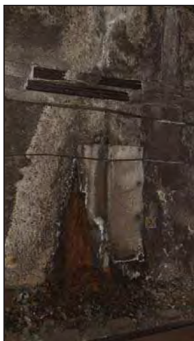
Foto 19: Filtració pantalla PK 106+400 v2.
