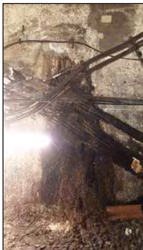
Foto 31: Filtració pantalla PK 106+980 v2.
