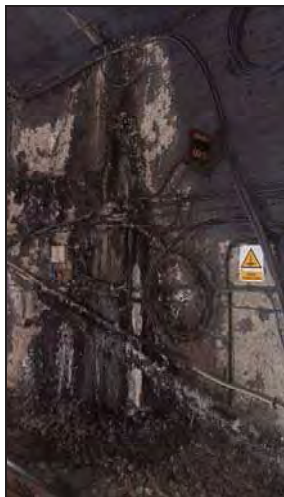
Foto 13: Filtració pantalla PK 106+215 v1.
