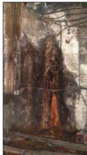
Foto 32: Filtració pantalla PK 106+986 v2.
