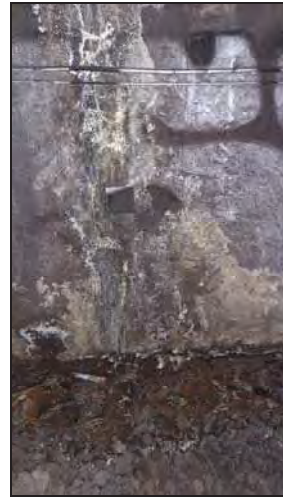
Foto 8: Filtració contravolta PK 105+950 v1.
