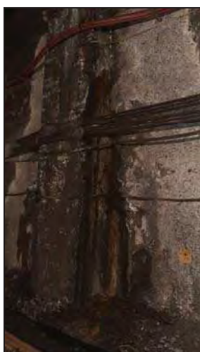
Foto 21: Filtració pantalla PK 106+660 v1.
