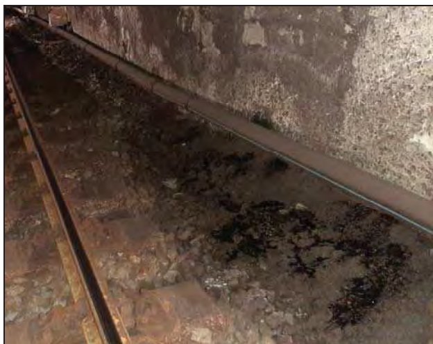
Foto 29: Filtració contravolta PK 106+900-950 v1.
