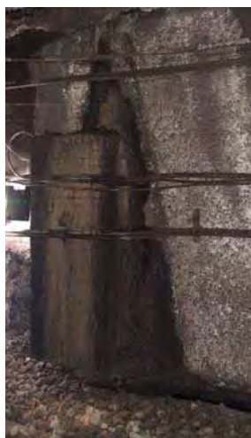
Foto 27: Filtració pantalla PK 106+897 v2.
