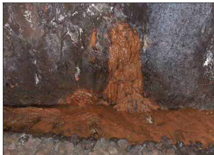
Foto 18: Filtració contravolta PK 106+400-8 v1.
