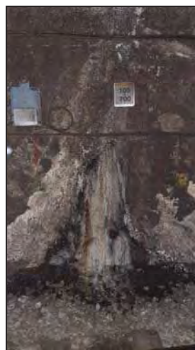
Foto 4: Filtració pantalla PK 105+700 v2.
