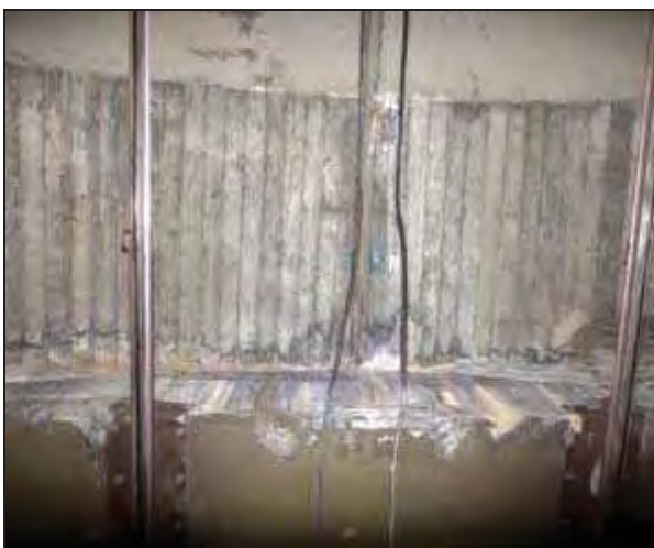
Foto 11: Armadura vista PK 105+150.
