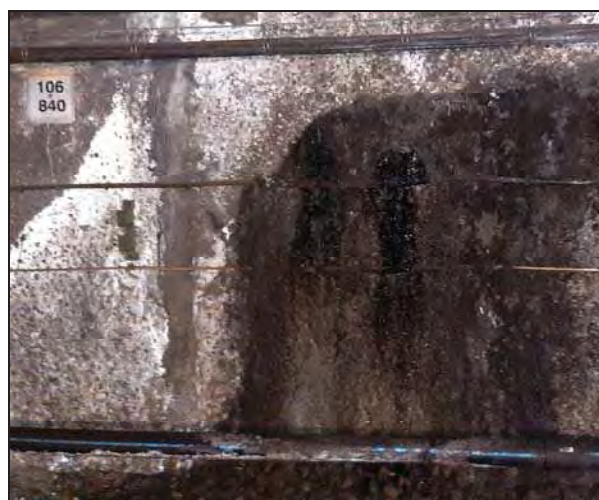
Foto 22: Filtració pantalla PK 106+840 v1.
