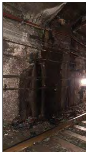
Foto 26: Filtració pantalla PK 106+890 v2.
