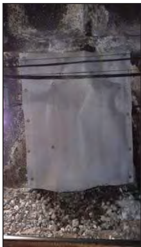
Foto 1: Filtració pantalla PK 105+300 v1.
