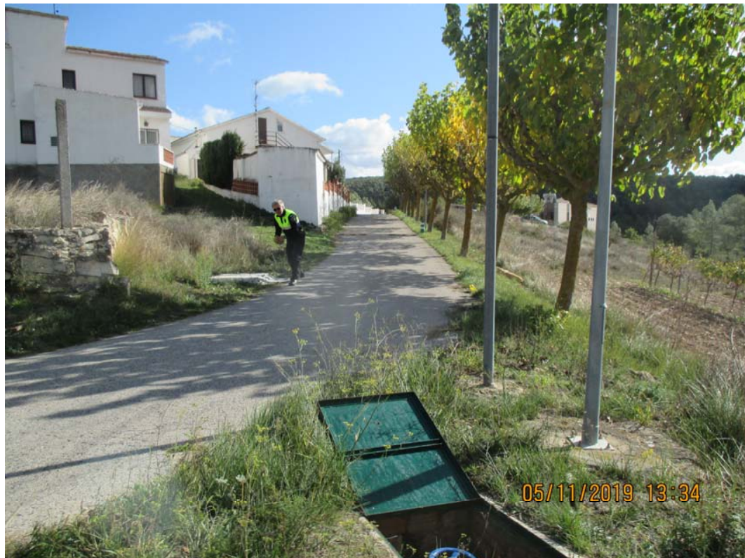
6. Arribada de l'aigua a Bonany. Arquetes de tall i de sectorització
