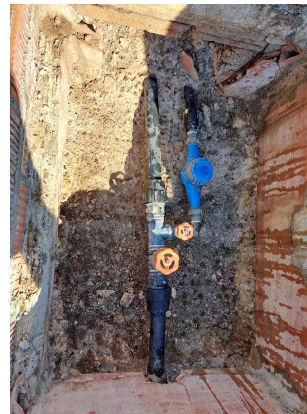
8. Bonany. Arqueta de sectorització dotada de comptador
