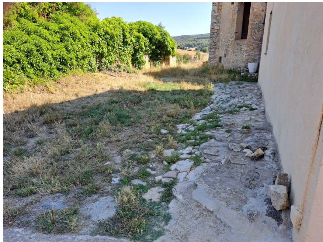
13. Bonany. Al final del passatge hi ha una escomesa pendent
