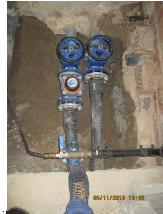
3. A la dreta entrada en alta a dipòsit i a l'esquerra sortida en baixa amb comptador.
