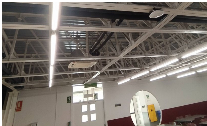
Fig. 4. Fancoils tipus cassette situats en la sala de treball central
