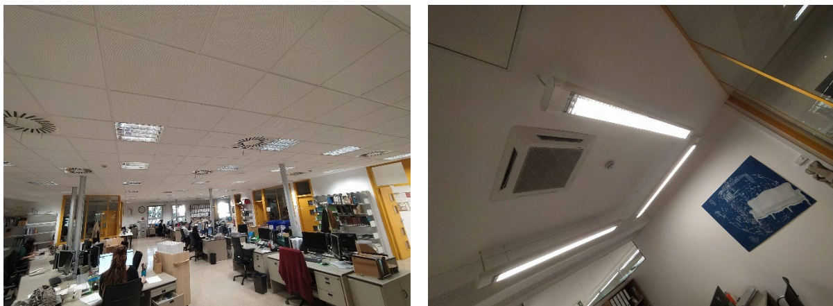
Fig. 5. Difusió de l'aire climatitzat en Àrea de treball i despatxos annexes
