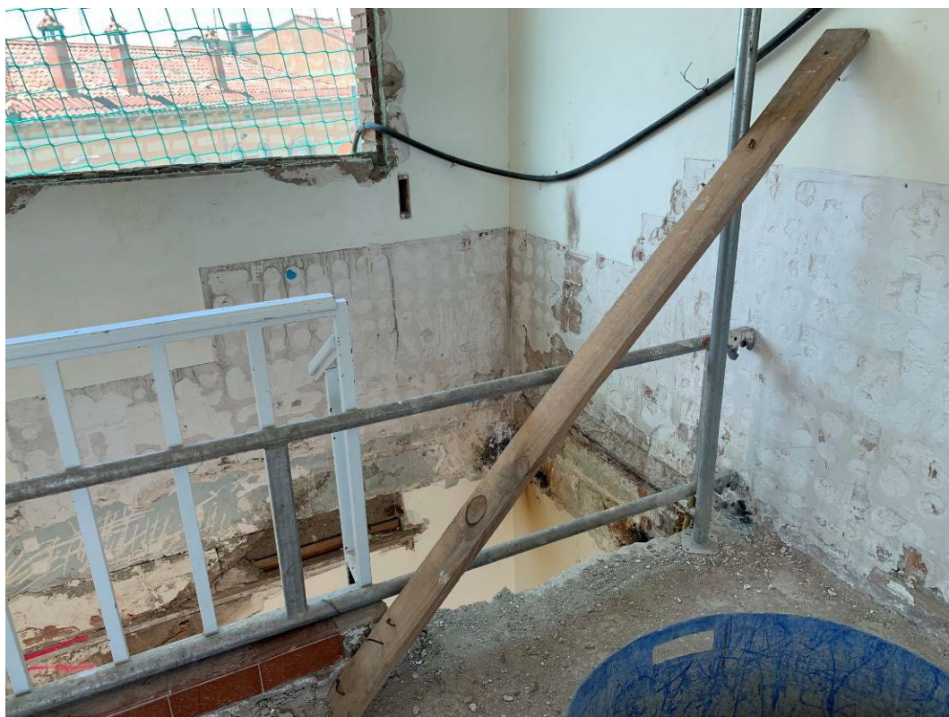
Foto 18: Interior. Zona escala enderrocada. Autor: ROA Arquitectura
