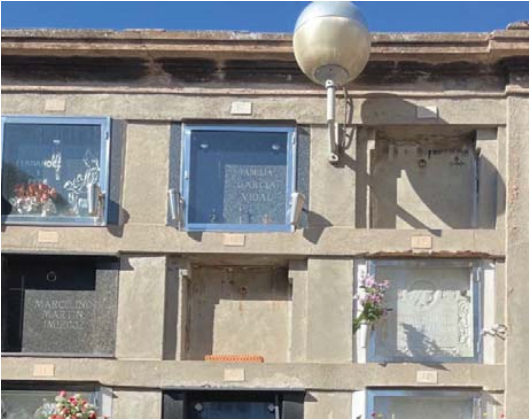
Detall de la cantonada superior amb esquerdes verticals que trenquen
