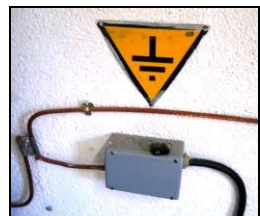
Connexió a terra
