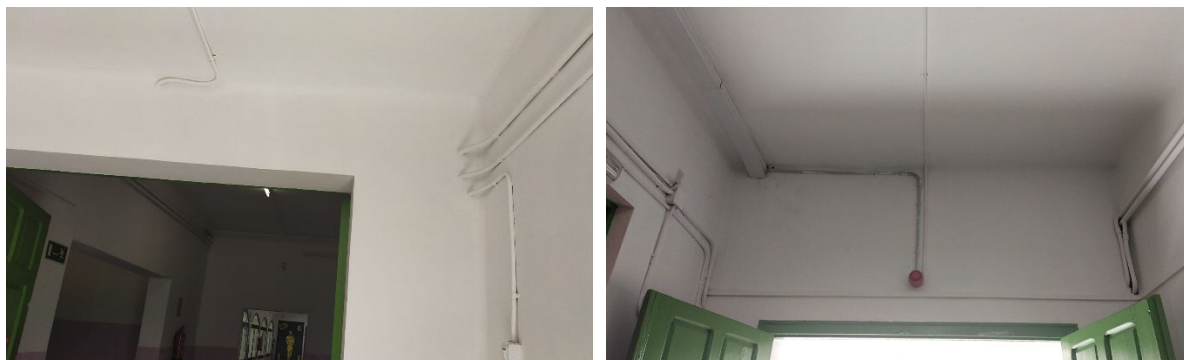
Il·lustració 25 Cablejat DC per l'interior de l'escola
