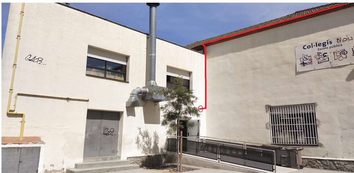
Il·lustració 24 Cablejat DC per coberta
