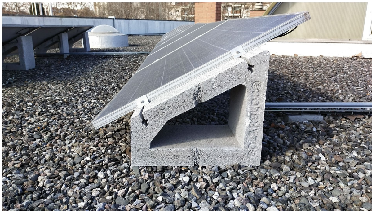
Il·lustració 13 Instal·lació fotovoltaica sobre suports SOLARBLOC
