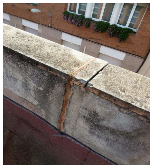
Juntas obertes entre cavallons
