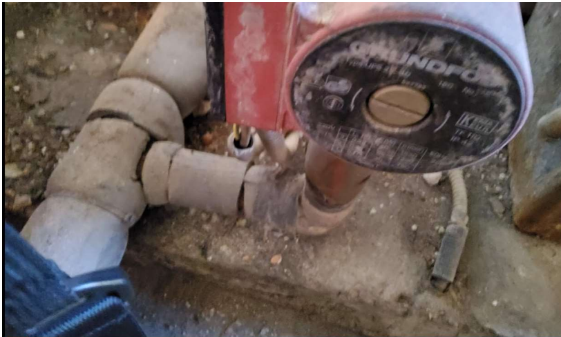
Bomba de recirculació de caldera.
