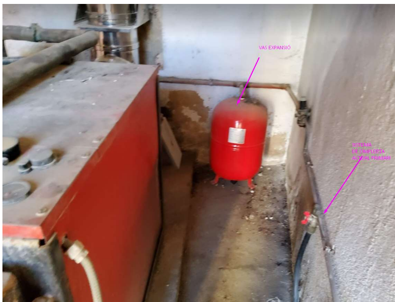
Sistema d'omplerta i vas d'expansió actual a l'antiga sala de calderes.
