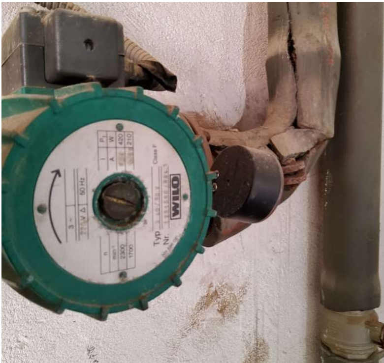
Bomba de recirculació de circuit de calefacció existent a mantenir.
