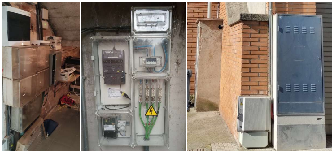
Imatge centralització comptadors, TMF fotovoltaica i CGP
