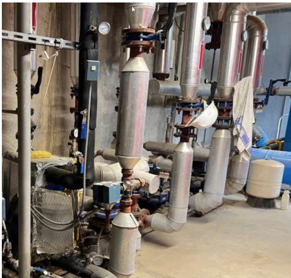
Foto.- Traçat interior planta soterrani, sala de calderes.
