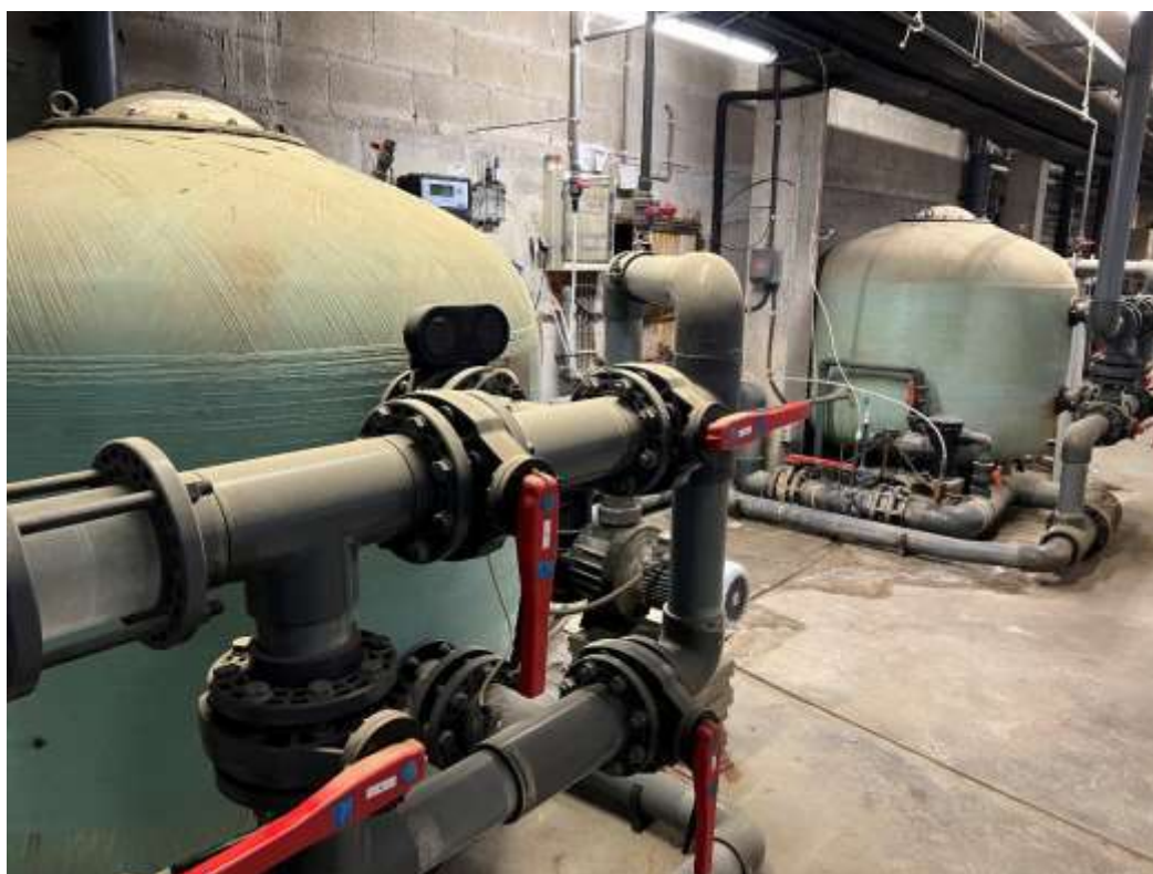
Foto.- Filtres piscina gran FI-F2
