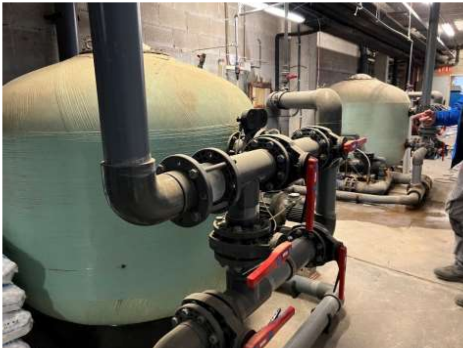
Foto.- Col·lector equips filtratge piscina gran F-1 i F-2
