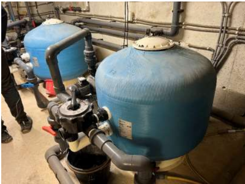
Foto.- Sistema filtratge piscina petita F3-F4
