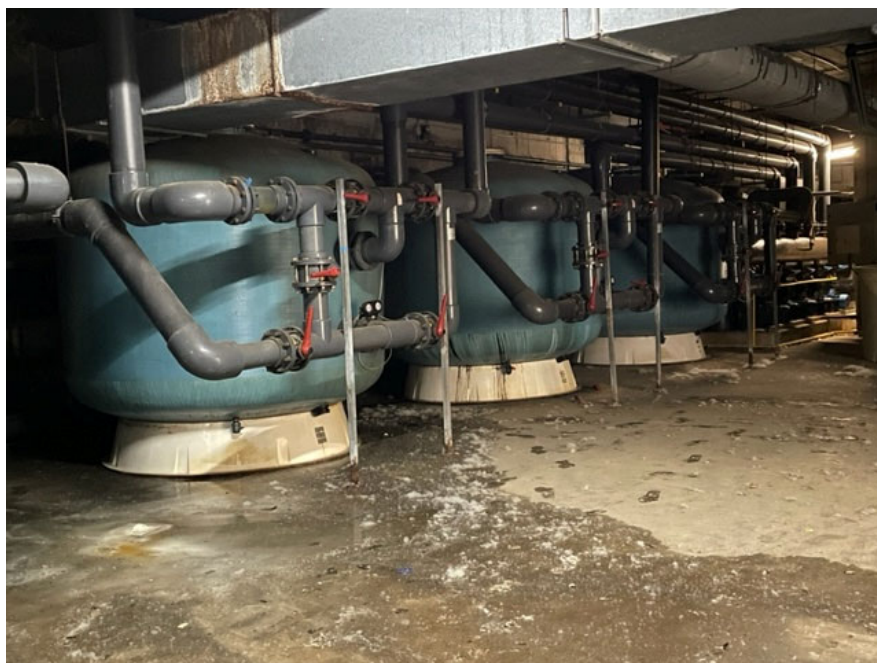
Foto2. Sala amb 3 dels 5 filtres de piscina exterior
