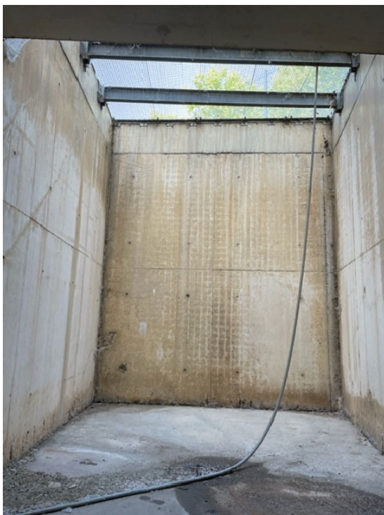
Foto1. Accés a la sala -1 a on es troben els filtres
