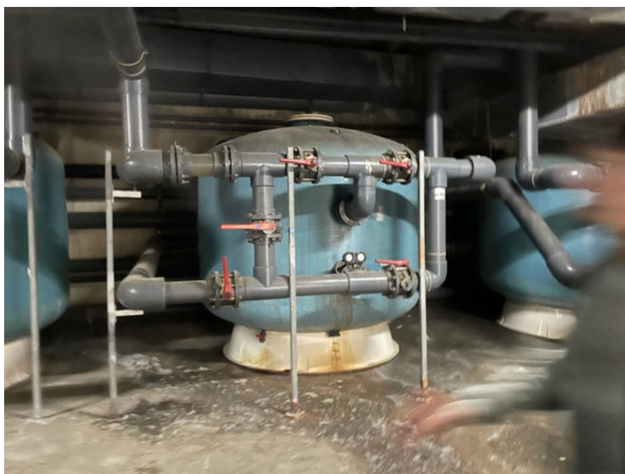
Foto 3. Filtre a substituir
