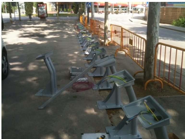
Cablejat d'alimentació i comunicació entre peus d'aparcament.
