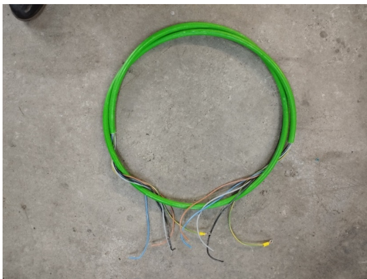
Imatge del cablejat de l'aparcament de Girocleta.
