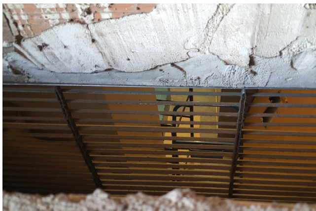
8. Reixa retorn aire acondicionat actual
