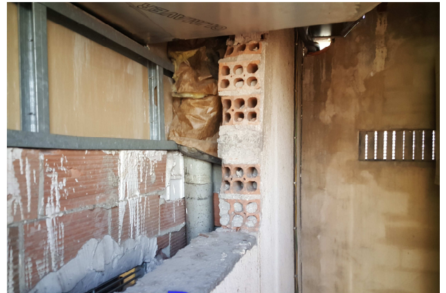
7. Retorn aire acondicionat actual
