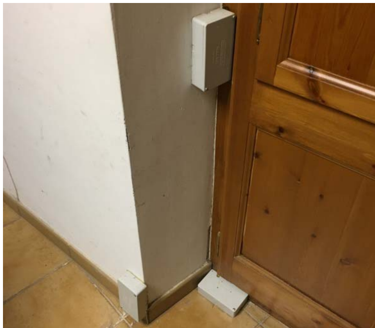
Caixes per control i detecció de termites.
