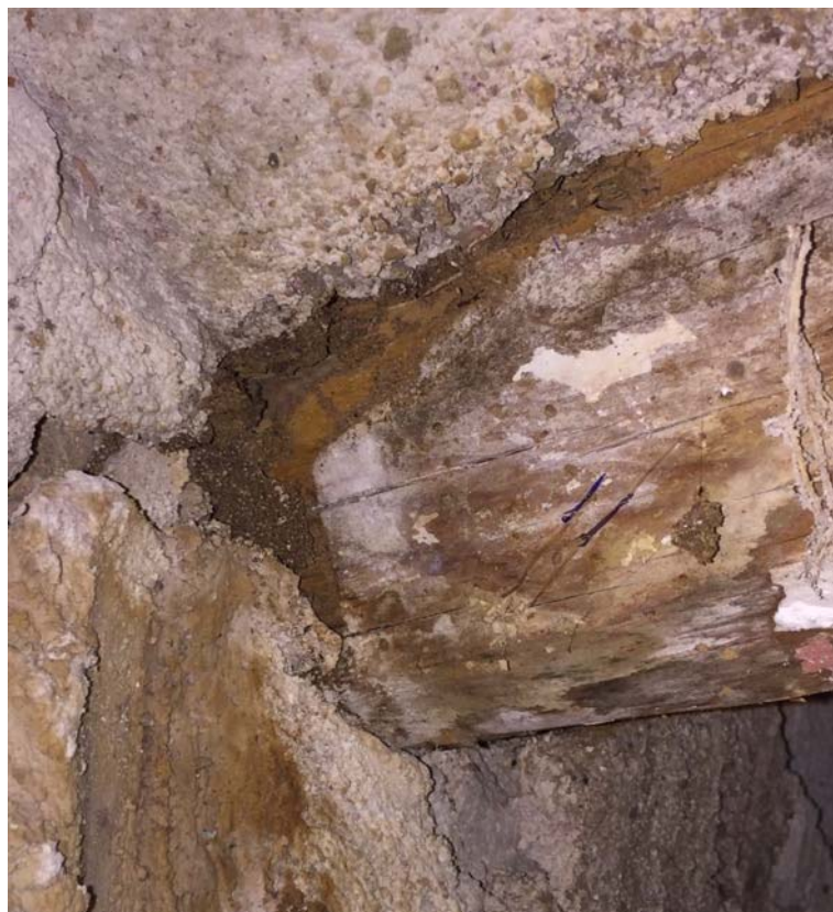
Cap de biguetes, amb restes de presència de termites i carcoma. Es pot apreciar el desplaçament vertical de l'element estructural. Aquesta patologia afecta diferents biguetes de la coberta.
