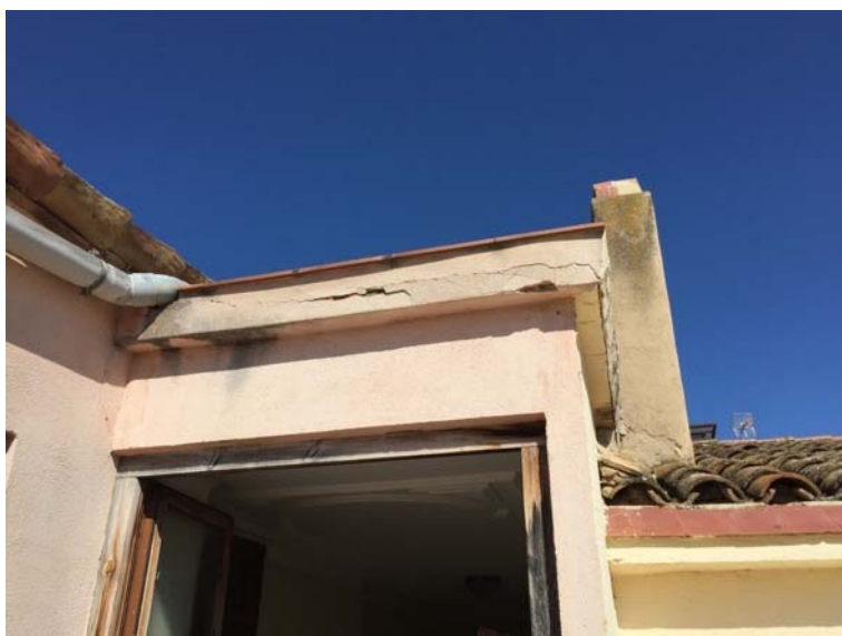
Cornisa de remat de la coberta plana, amb esquerdes i despreniment de material de revestiment.
