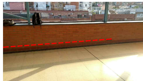
Actuació 5A. Vista més propera de la zona a segellar. Aquesta intervenció contempla la substitució del maó trencat
