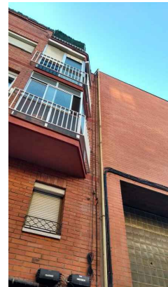
Actuació 3J. Detall zona afectada
