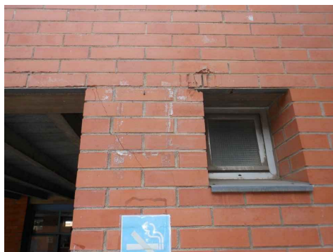
Actuació 5d. Fissura a segellar i maó a restituir
