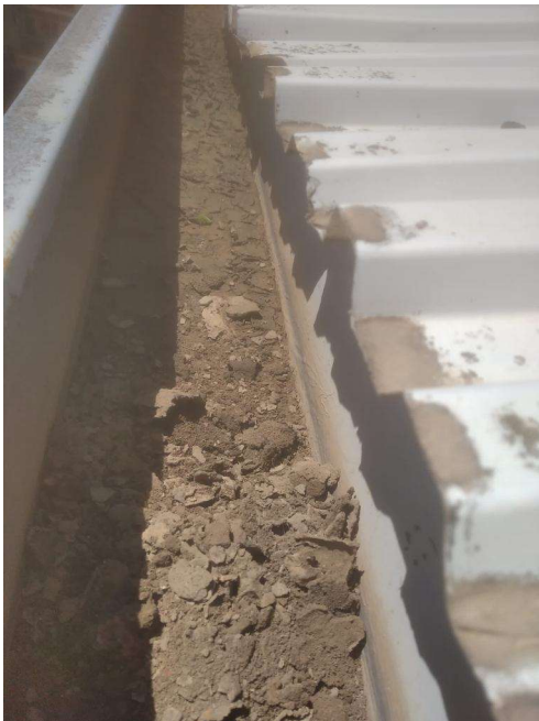
Estat inicial de la canal de la façana del pati interior
