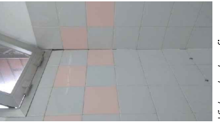
Vista de les fissures a l'interior del bany
