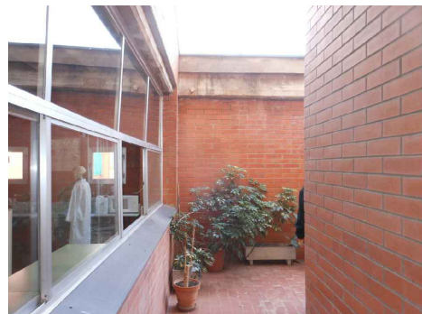
Actuació 6A. Vista general del pati on es situen les eflorescències
