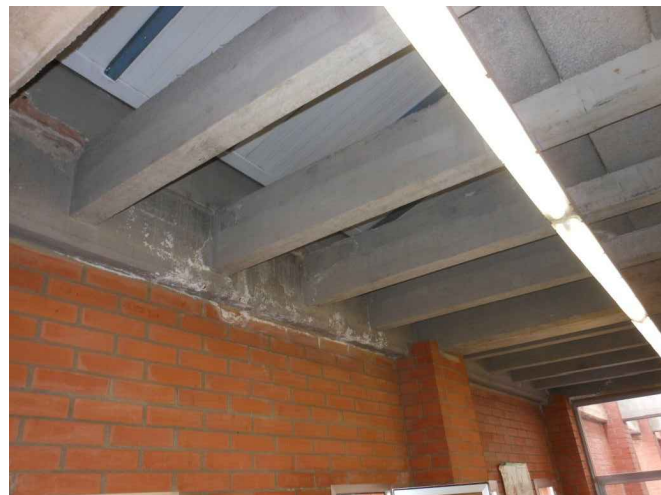
Actuació 6B. Vista general de l'aula on apareixen les eflorescències
