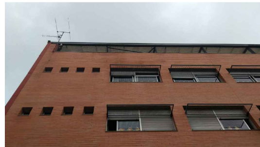
Fissures al costat esquerre, a la planta quarta
