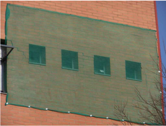
Actuació 3I. Detall zona afectada
