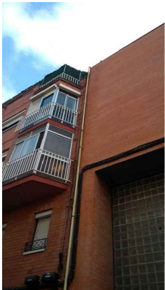
Actuació 3J. Detall zona afectada
