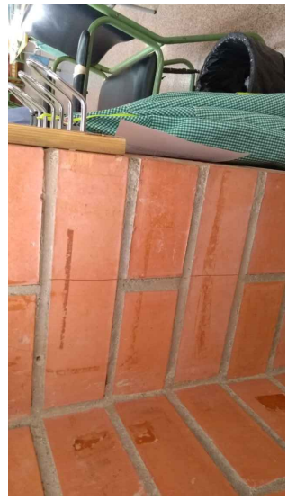
Vista de la fissura del matxó
