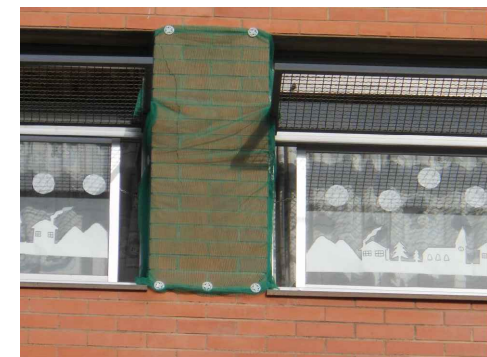
Actuació 5b. Vista de la fissura a segellar
