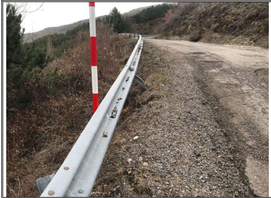
Figura 11. Vista actual dels trams on en el cas de la imatge cal reinstal·lar vallat de protecció per degradació de l'existent: entre el Pont de Suert i el pont de Saraís. Desembre 2022
