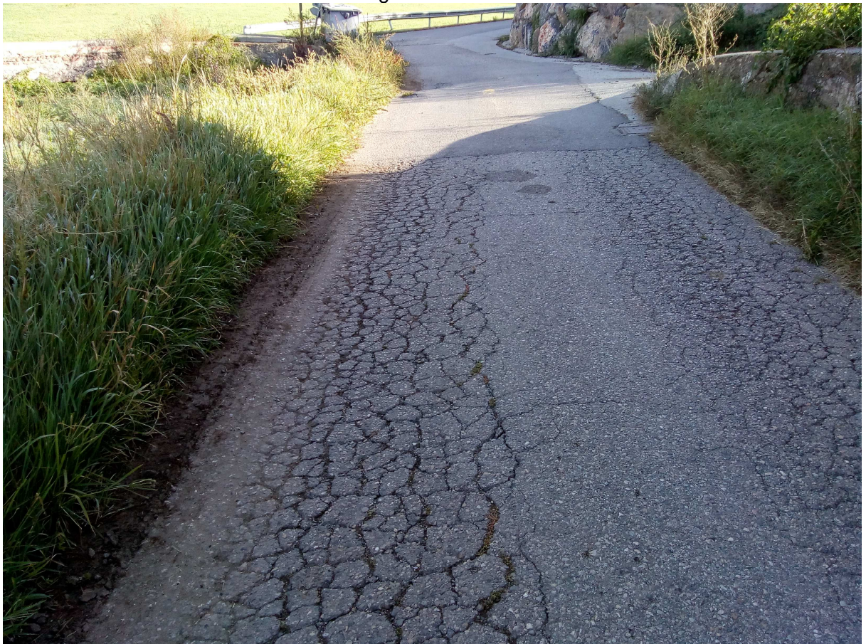
Estat del paviment enfonsat
