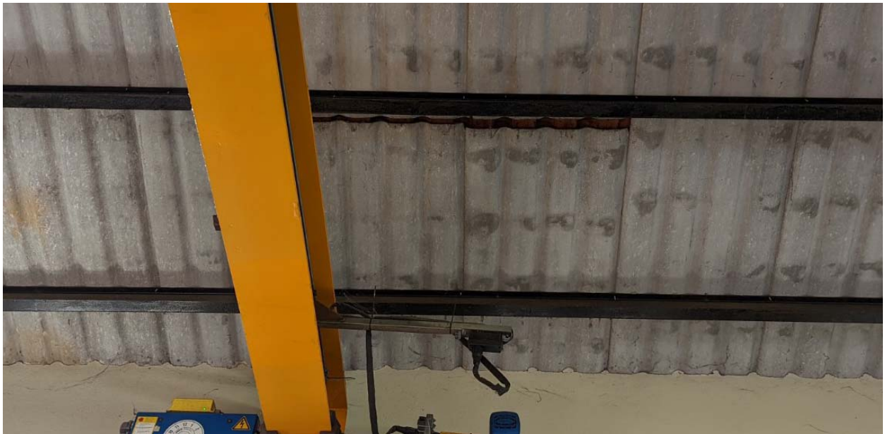
Lliscament de les plaques de fibrociment intermitges
