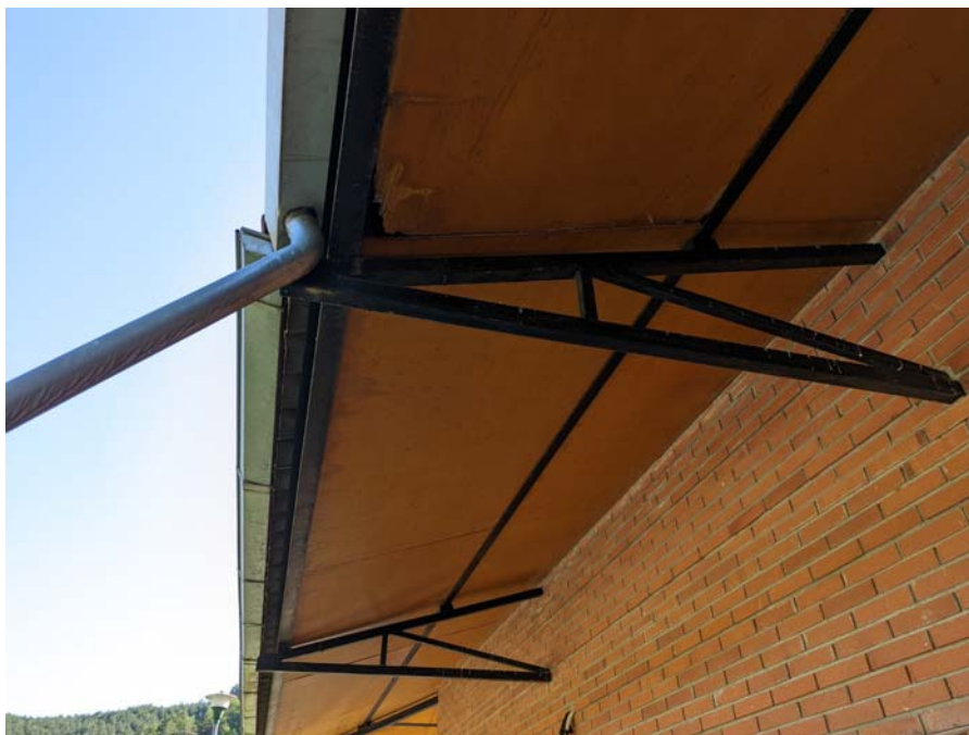
Deteriorament de la placa de fusta de sota els voladissos
