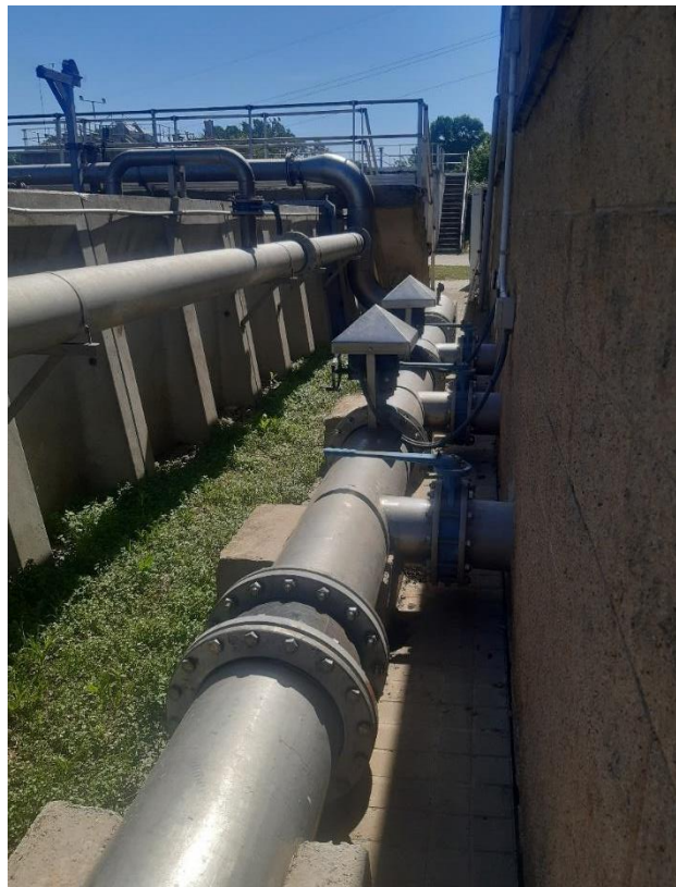
Imatge núm. 1.- Vàlvules elèctriques actuals instal·lades del col·lector de l'aire.
