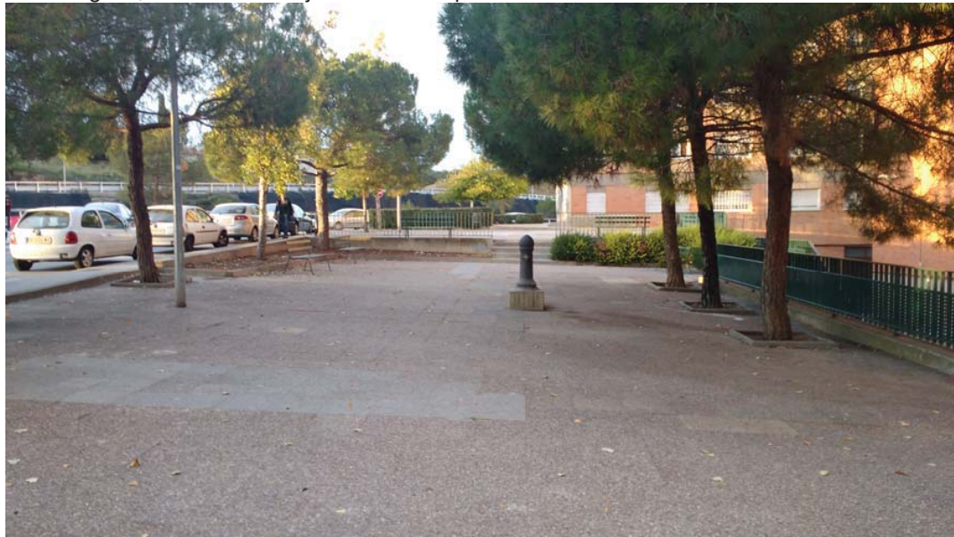
F2. Imatge de la plataforma central. S'observen els diferents intervencions en reparacions successives de paviment. Aquest paviment està en mal estat (deformacions). Es proposa substituir aquest paviment per sauló estabilitzat. Al centre de la plataforma s'observa l'actual font d'aigua (que no es desplaça) i un dels fanals de la plaça (objecte de desplaçament per la nova distribució). També s'observen els escocells objecte d'ampliació i les jardineres objecte de replantació.
