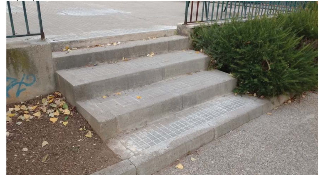
F4. Detall de l'estat actual de l'escala que separa la plataforma intermitja amb la superior. També s'observa com el graonat és desigual, no disposa de barana i el paviment no és homogeni. Es proposa la creació de la nova escala. Per altra banda s'observa el deteriorament de les baranes que configuren la totalitat de la plaça. Per aquest motiu es preveu la reparació i pintat d'aquests elements en la seva totalitat.
