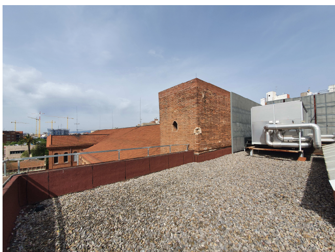
Foto 10 .Bomba de Calor Prod. Aigua
