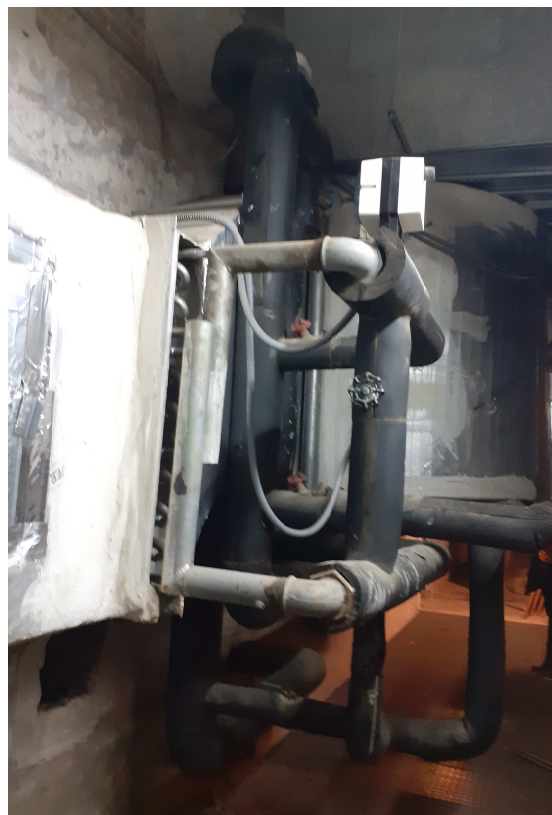
Foto 09. Conductes impulsió amb bateries
