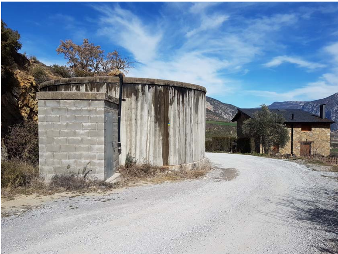
Foto 23: Dipòsit existent més nou de 100 m 3
