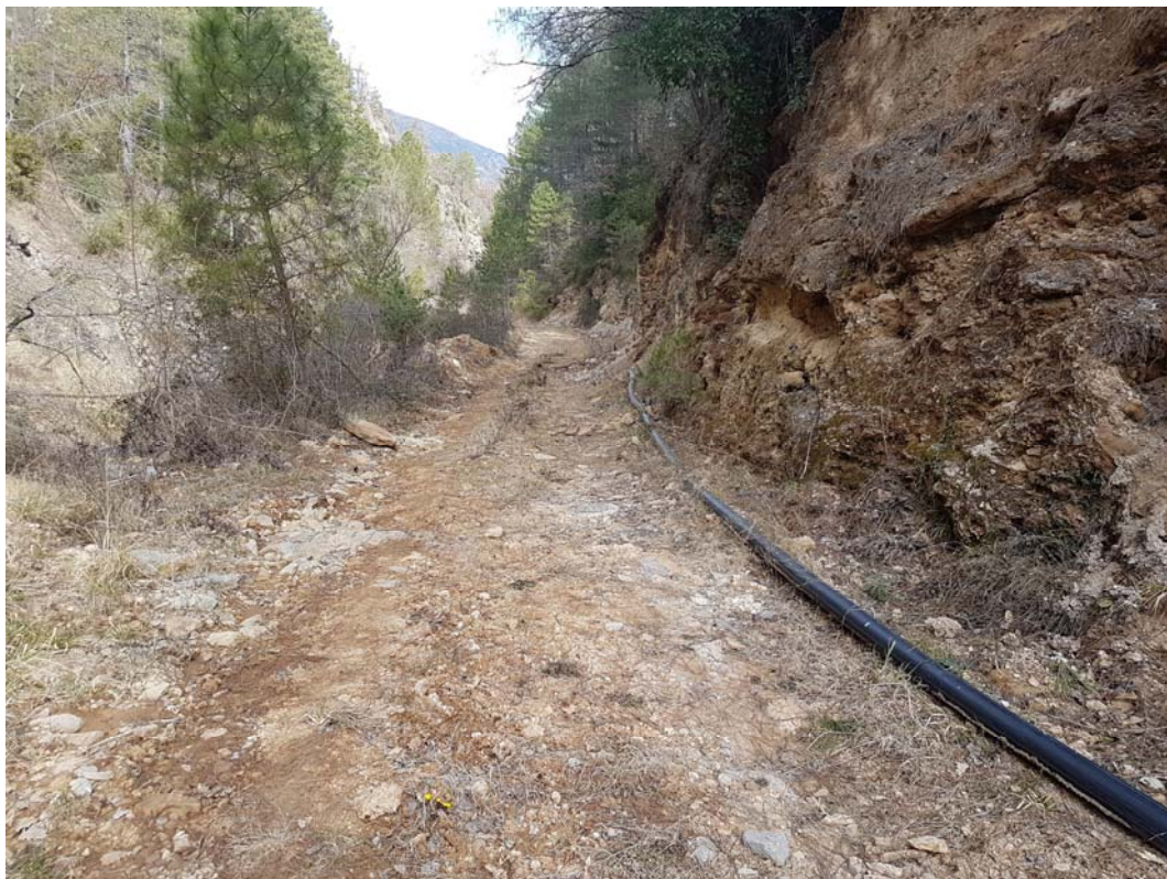
Foto 9: Camí i canonada actual en servei P.Q. 0+060 (vista aigües avall)
