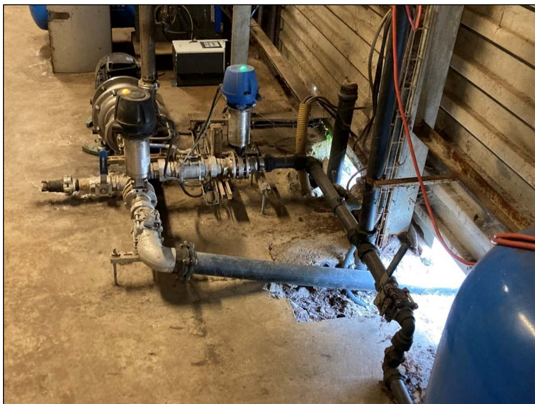
Foto-08. e30.21.spr.sistema de reg-220503. Etapa bombament lixiviats
