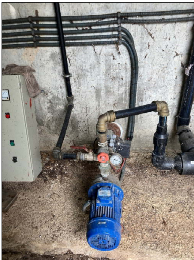
Foto-05'. e30.21.spr.sistema de reg-220503. Etapa Bombament Pluvials (12 m 3 /h 40 mca)
