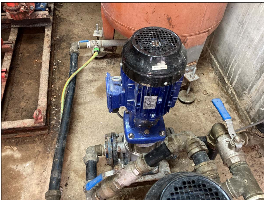
Foto-05. e30.21.spr.sistema de reg-220503. Etapa Bombament Pluvials (18 m 3 /h 42 mca)
