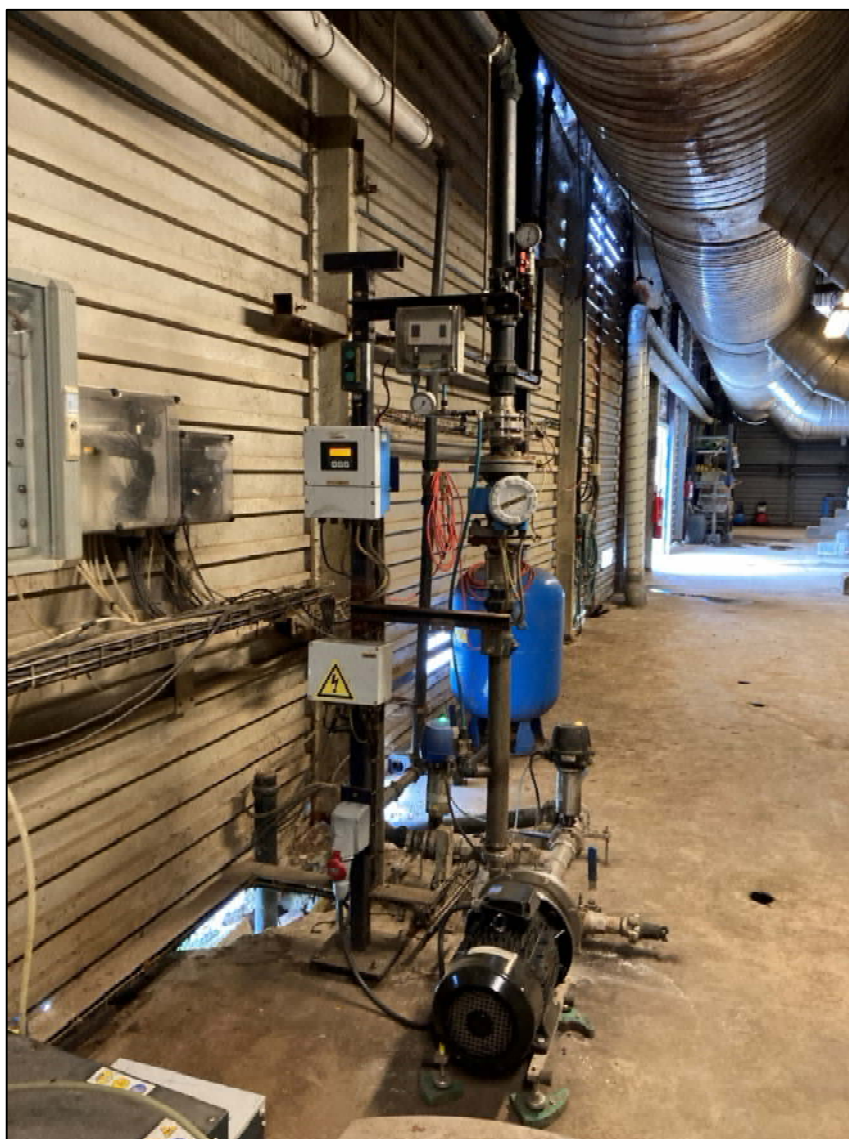
Foto-09.e30.21.spr.sistema de reg-220503. Etapa bombament llixiviats
