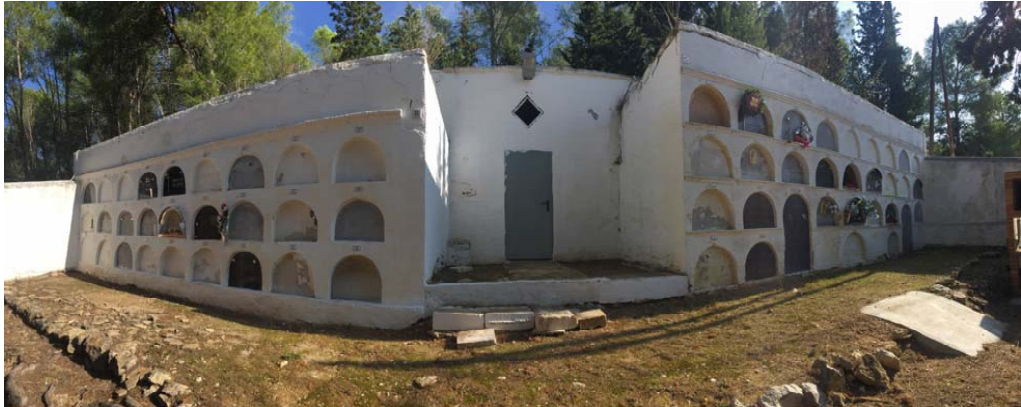
Vista general Nínols a reforçar cobertes i capella.
