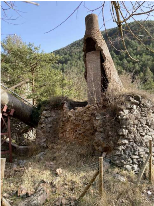
Parets del forn en mal estat
