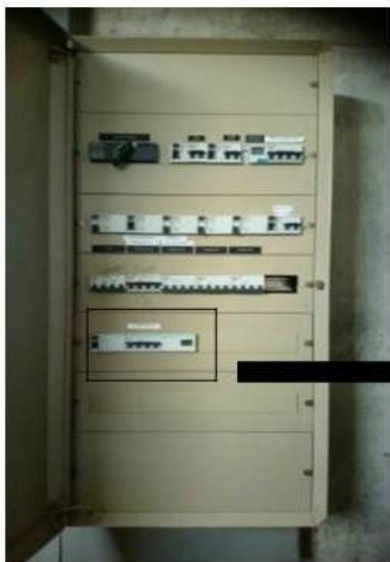
Quadre General elèctric (QG)
