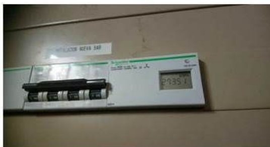
Comptador diferencial elèctric a QG
