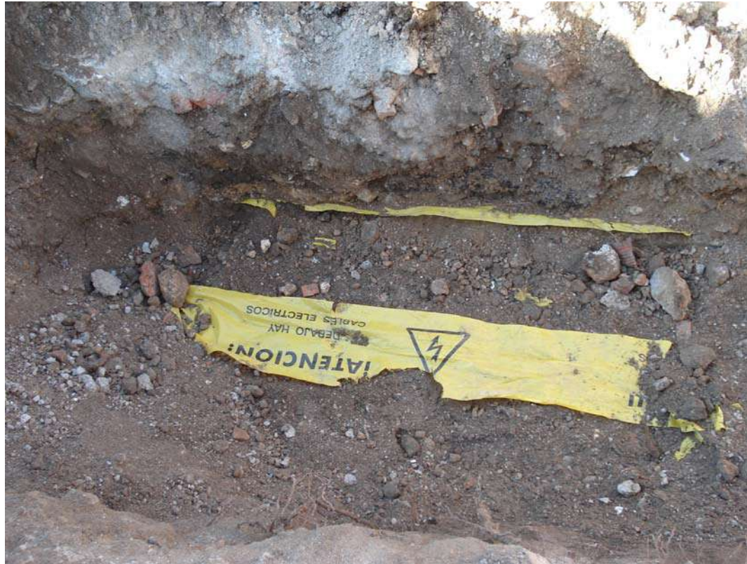
Fotografia 1: Línia elèctrica soterrada a la cala C-2 a 0,65 m de fondària.
