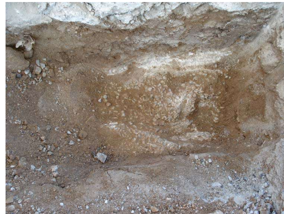
Fotografia 7: Solera de formigó en massa que recobreix SSAA. Probablement fibra òptica. Detectat a la cala C-24 a 0,95 m de fondària.
