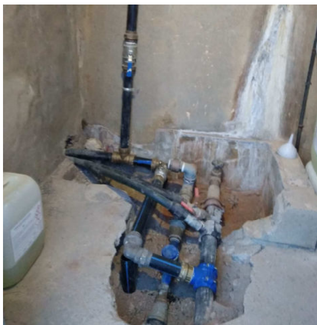
Figura 2. Caseta del dipòsit: espai de vàlvules i canalitzacions
