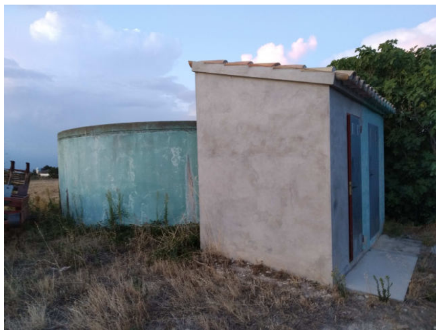
Figura 1. Dipòsit i caseta del dipòsit
