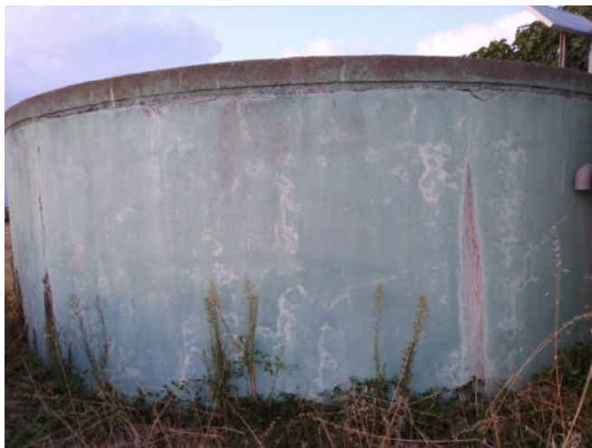
Figura 1. Esquerdes i fissures en els murs laterals del dipòsit
