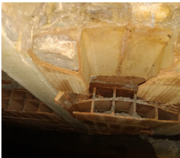
Figura 2. Patologies dels revoltons de la coberta
