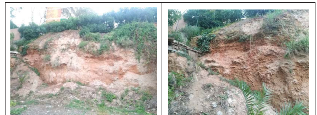
Detall del front del talús on s'observen indicis d'erosió progressiva
