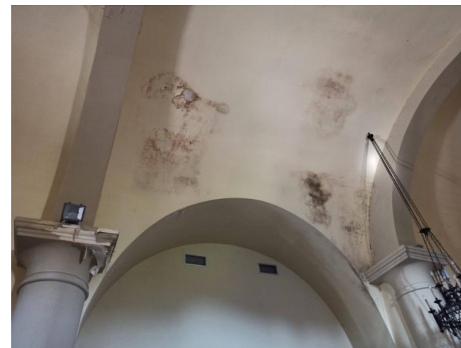
Zones afectades per l'aigua en cel ras. Es pot veure les reixes de ventilació del trasdossat del mur oest JS (2021)
