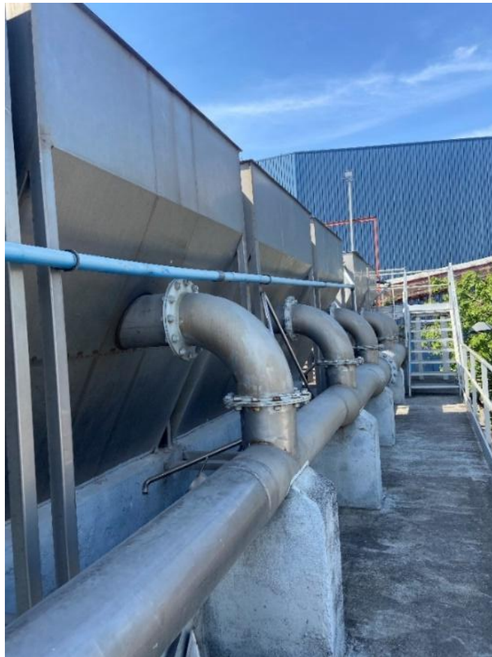
Fotografia núm. 1: colzes d'entrada d'aigua de cadascun dels Hidranets on s'hauran de col·locar les brides cegues per deixar-los aïllats de l'entrada de l'aigua.
