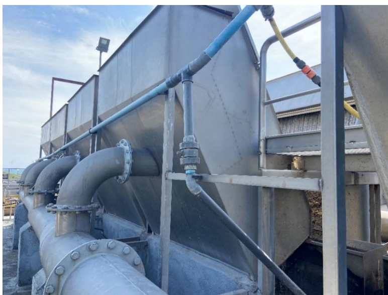
Tubs de PVC actuals d'aigua de neteja dels canals.
