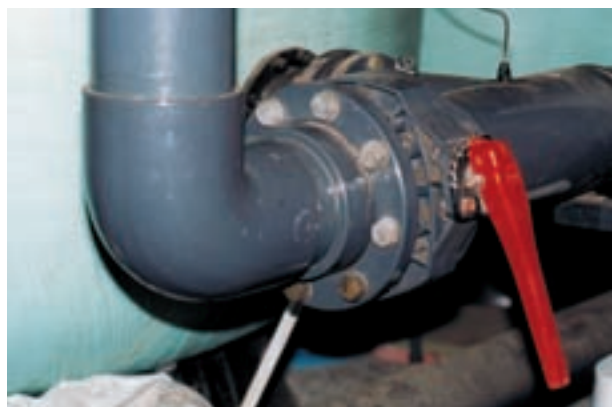
Imatge de la sala tècnica
