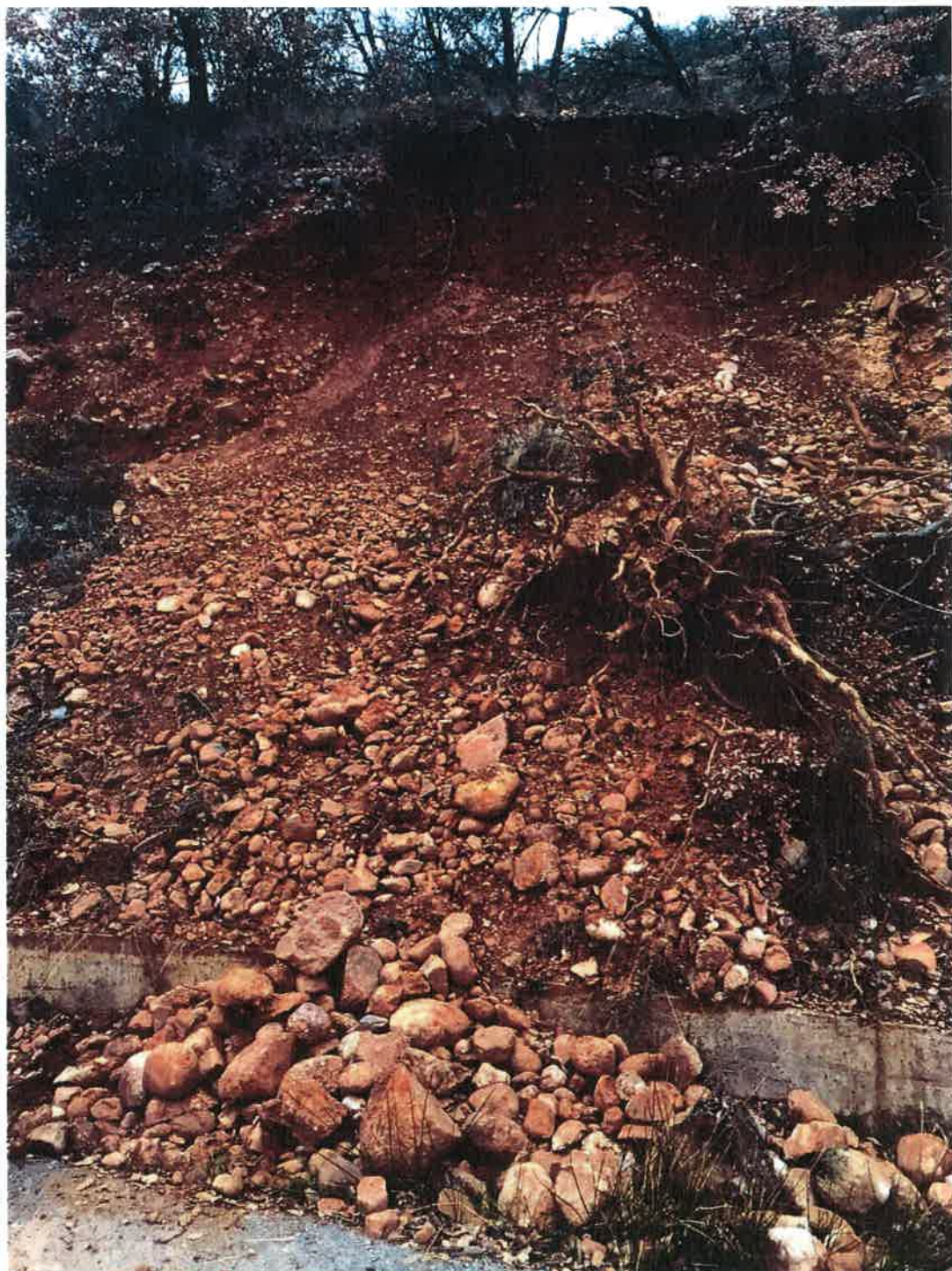
Mur de pedra seca caigut a l'entrada de la localitat de Rivert
