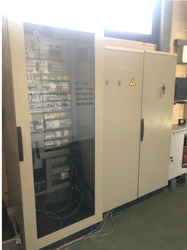
Imatge dels 2 quadres actuals. A l'esquerre (amb porta de vidre) el de distribució, i a la dreta el de maniobra
