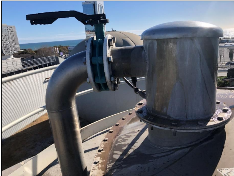
Imatge núm.14: Vista de la cúpula del digestor núm. 2 amb la vàlvula de seguretat i la vàlvula de papallona a continuació (a l'inici de la canonada de sortida del gas cap al gasòmetre).
