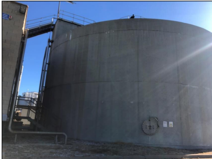
Imatge núm.1 – Vista general del digestor anaerobi número 2.
