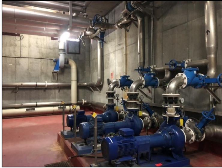
Imatge número 2 – Bombes de recirculació (2+1) de fangs del digestor i part del sistema de canonades (situat al soterrani de l'edifici de digestió).
