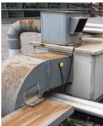
Fig. 6. Extractor ubicat sobre la UTA dreta
