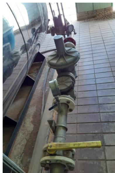
Rampa de biogàs
