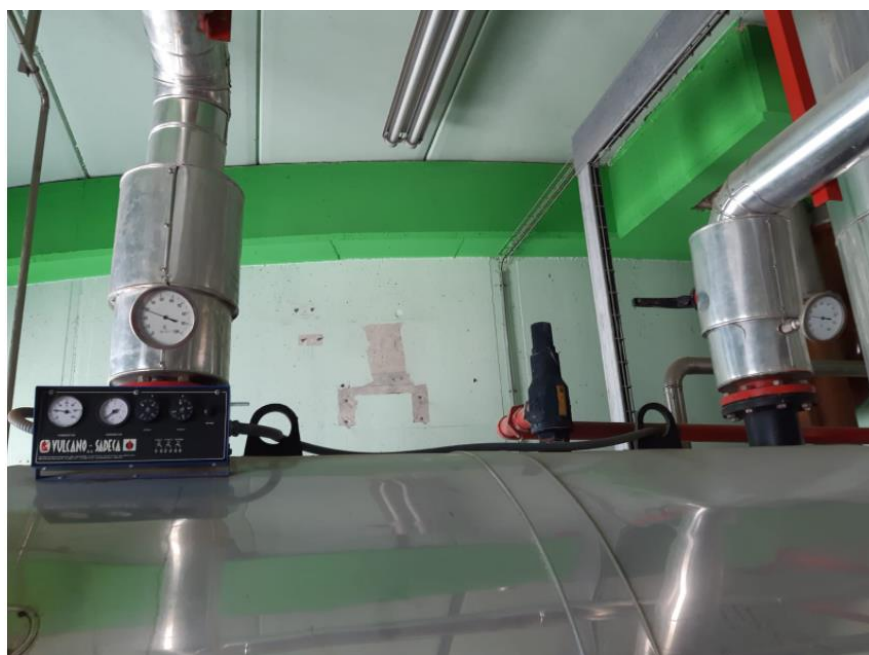
Quadre control caldera i vàlvules d'entrada i sortida (incloses en l'abast dels treballs)
