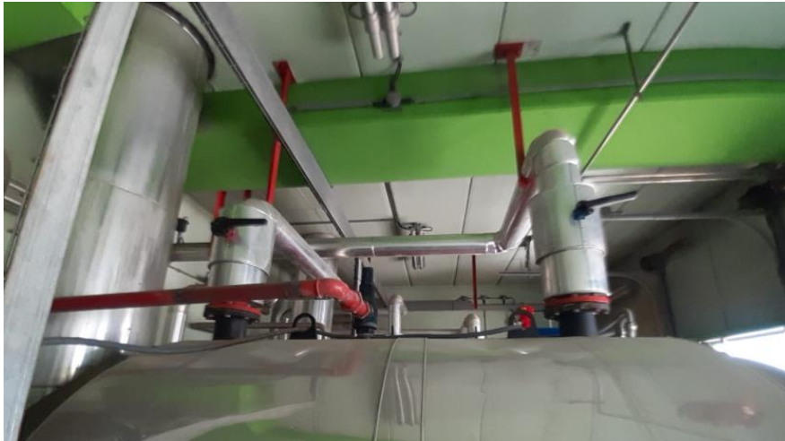
Vàlvules d'entrada i sortida a la caldera (incloses en l'abast dels treballs)
