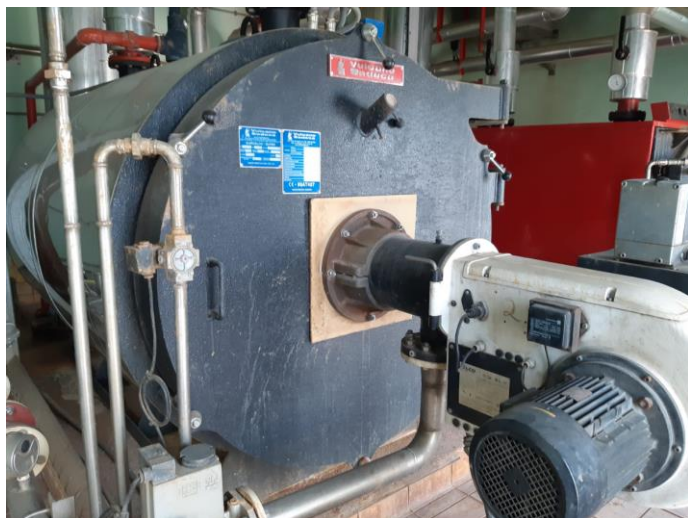
Unitat caldera-cremador a substituir
