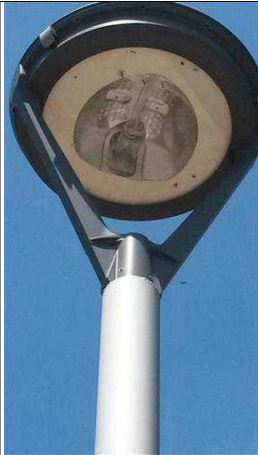
Foto 6: Luminàries vials existents a substituir grup òptic existent
