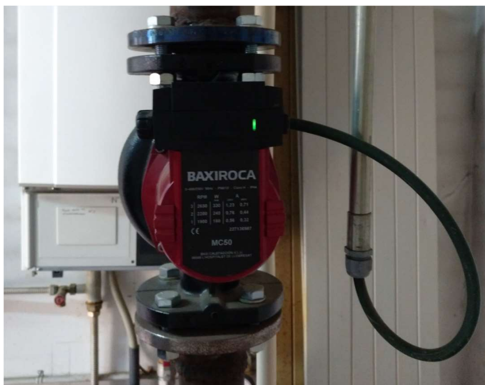
Imatge 1.- Bomba circuladora de l'edifici de l'Escola
