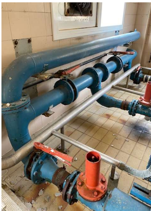
Figura 2. Corrosió a la canonada d'impulsió d'aire i valvuleria
