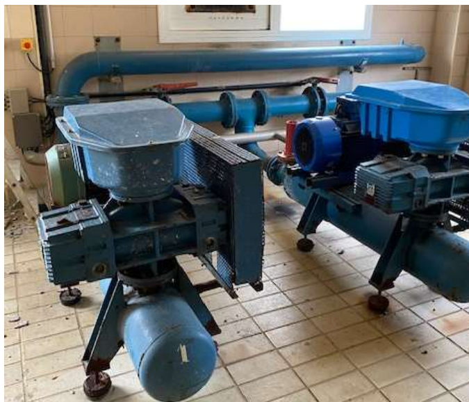
Figura 1. Bufadors existents per al pretractament de l'EDAR de Lloret de Mar
