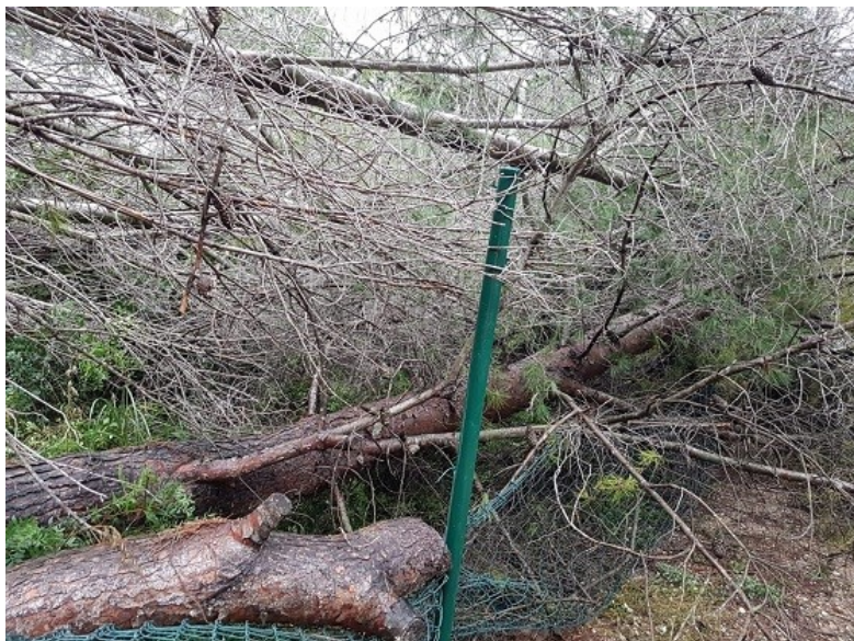
Caiguda d'arbres sobre la tanca perimetral de l'EDAR.
