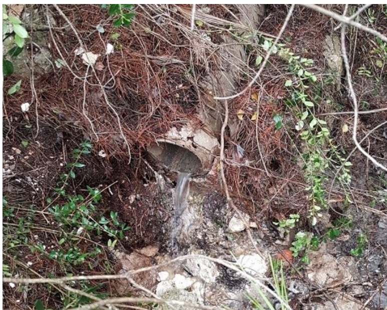
Vista del col·lector trencat.
