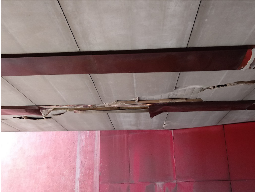
Foto nº 6. Canals metàl·lics de desaigna trencades en del pas inferior Ctra. BCN trencades.
