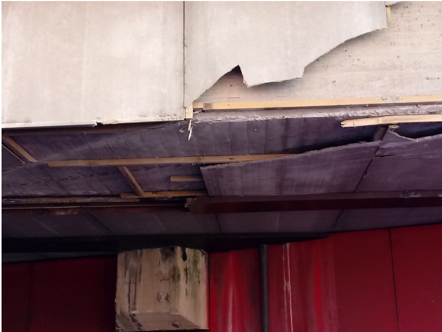
Foto nº 4. Peces verticals del cel ras en la cara Est del pas inferior Ctra. BCN trencades.
