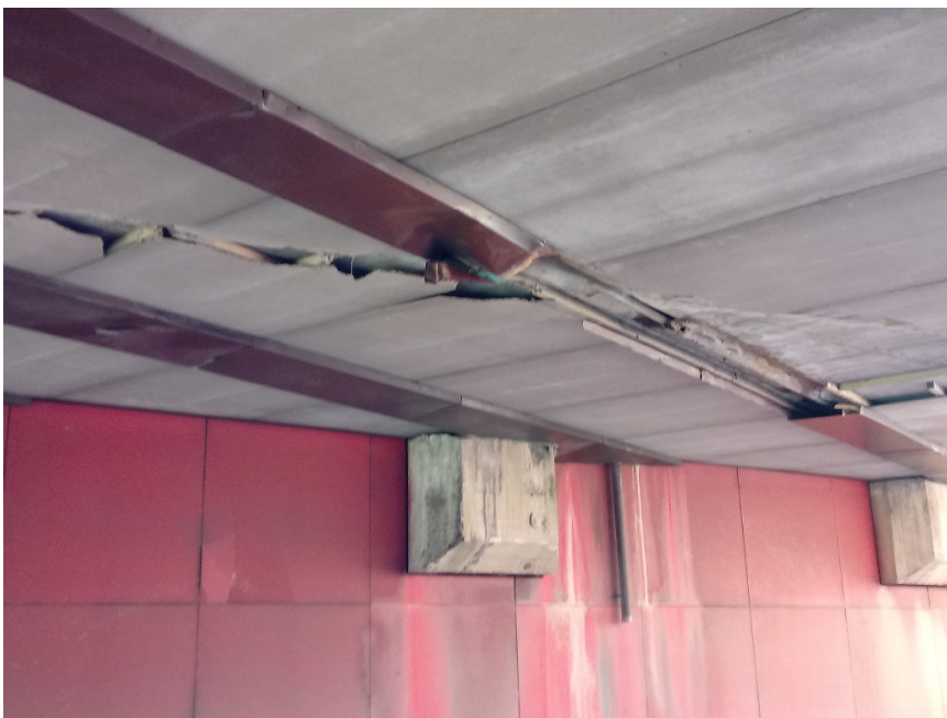
Foto nº 7. Plaques inferiors del pont trencades.
