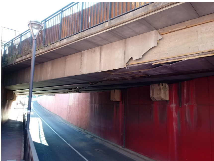
Foto nº 2. Peces verticals del cel ras en la cara Est del pas inferior Ctra. BCN trencades.
