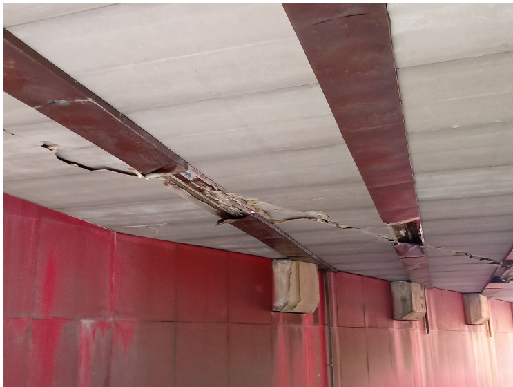
Foto nº 5. Canals metàl·lics de desaigna trencades en del pas inferior Ctra. BCN trenca- des.
