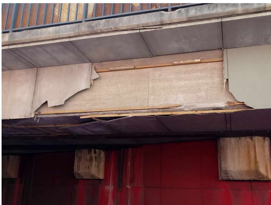
Foto nº 3. Peces verticals del cel ras en la cara Est del pas inferior Ctra. BCN trencades.
